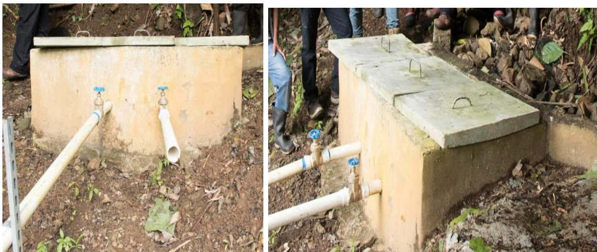
Figura 13- Vistas de caja de segunda captación mejorada - La Conga Abajo y Tres Hermanas Centro
