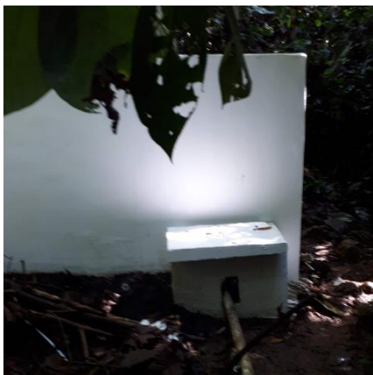
Figura 33- Vista de tanque de almacenamiento mejorado con su caja de válvula - El Limón
