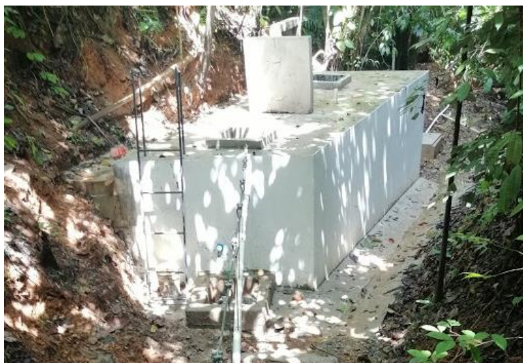
Figura 35- Visas de nuevo tanque de almacenamiento - El Limón
