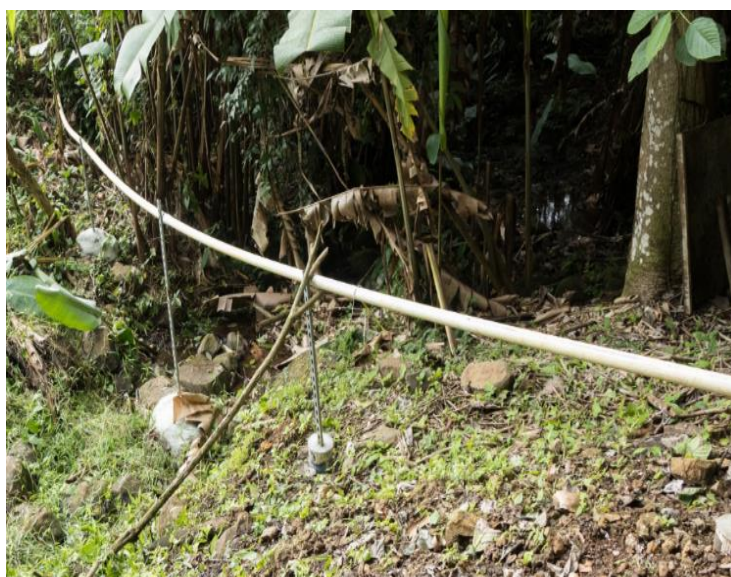
Figura 14- Nuevo tramo de tubería de conducción con soportes - La Conga Abajo y Tres Hermanas Centro
