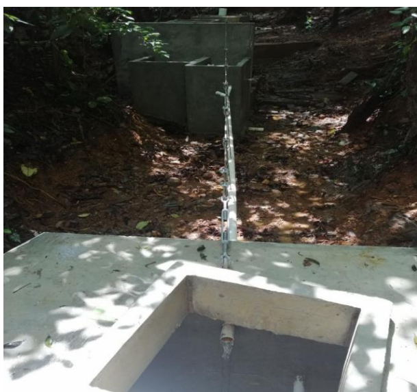
Figura 32- Cruce área de tubería de conducción - El Limón
