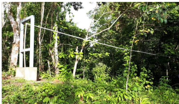
Figura 18- Vistas de nuevo cruce Aéreo de quebrada La Conga Abajo
