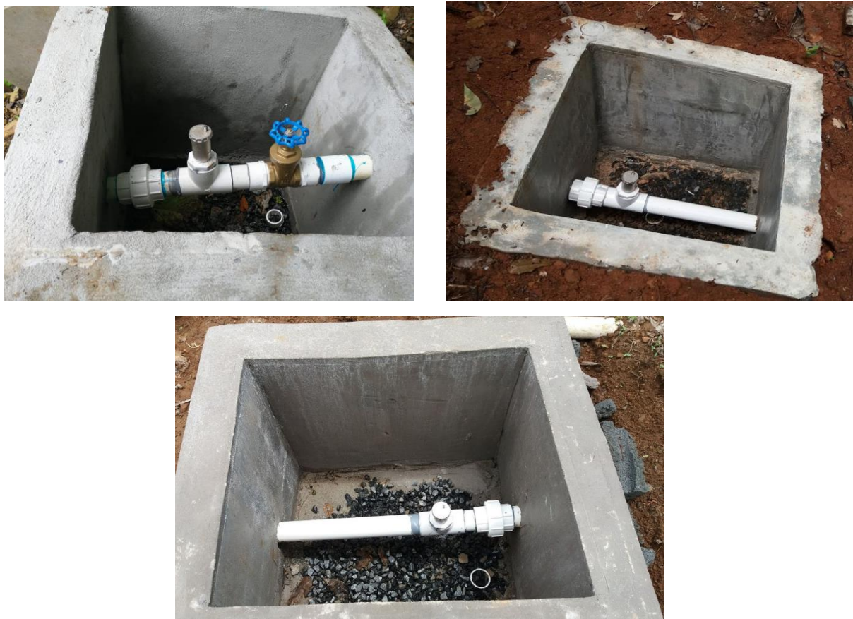
Figura 25- Vistas de cajas de válvulas de expulsión de aire
