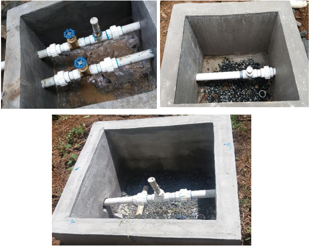
Figura 40-Vistas de cajas de válvulas de limpieza - El Limón
