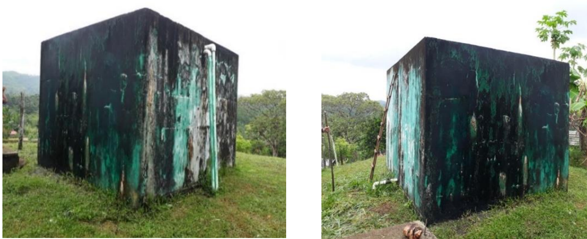
Figura 7- Vistas de condiciones iniciales de tanque de almacenamiento - Barriada San Antonio
