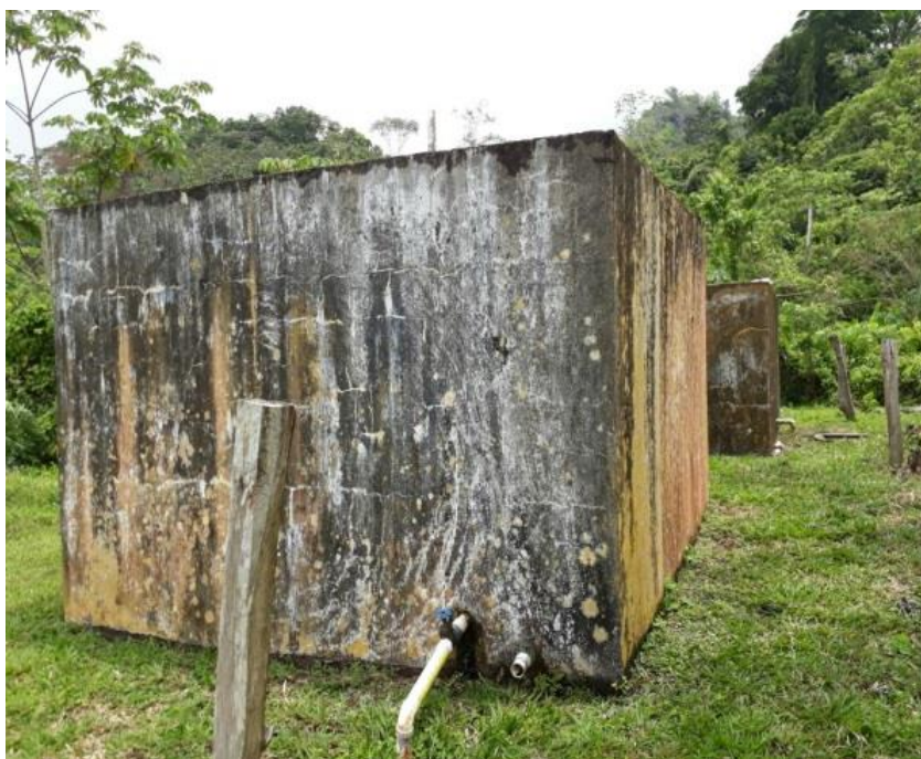
Figura 3- Imagen de condición inicial de tanque de almacenamiento del sector Tres Hermanas Centro
