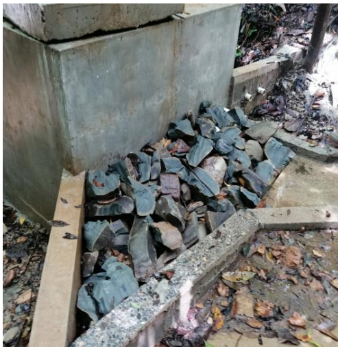
Figura 27- Entrada de agua a captación superficial - El Limón
