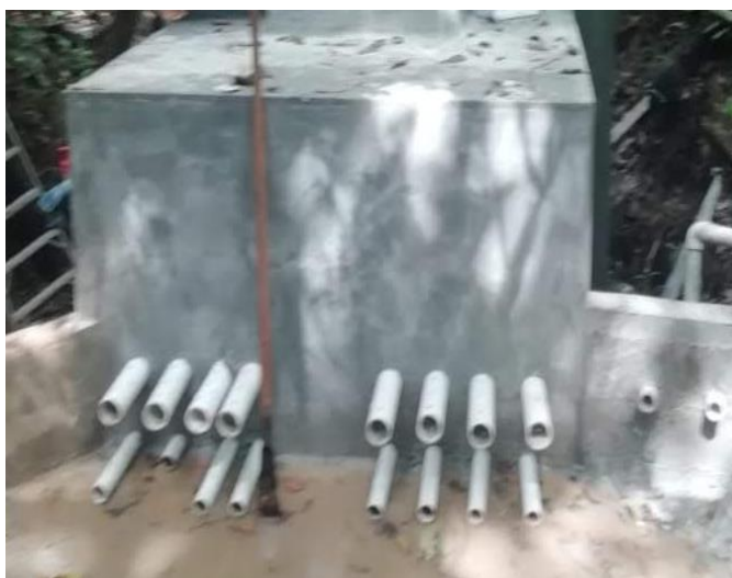
Figura 29- Vista de tuberías perforadas y muro laterales-El Limón
