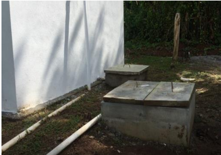
Figura 16- Vistas de cajas de válvulas con sus tapas, válvulas y filtro - La Conga Abajo y Tres Hermanas Centro
