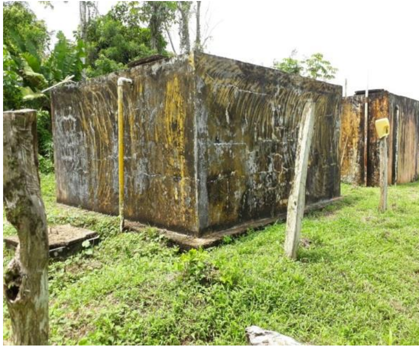
Figura 4- Imagen de condición inicial de tanque de almacenamiento del sector La Conga Abajo
