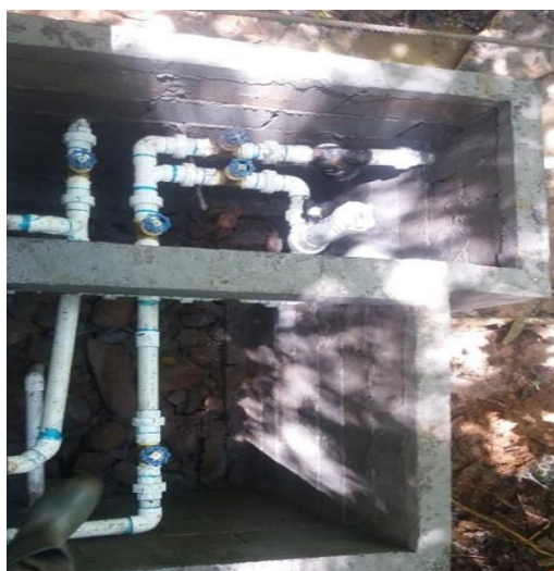
Figura 30- Caja donde está instalado el clorinador, válvulas de control de flujo, válvula de limpieza y filtro de malla – El Limón
