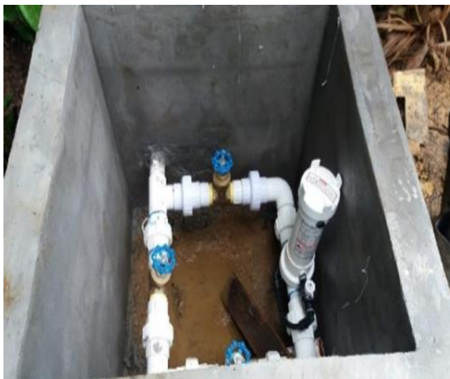
Figura 34- Vista de caja y clorinador - El Limón
