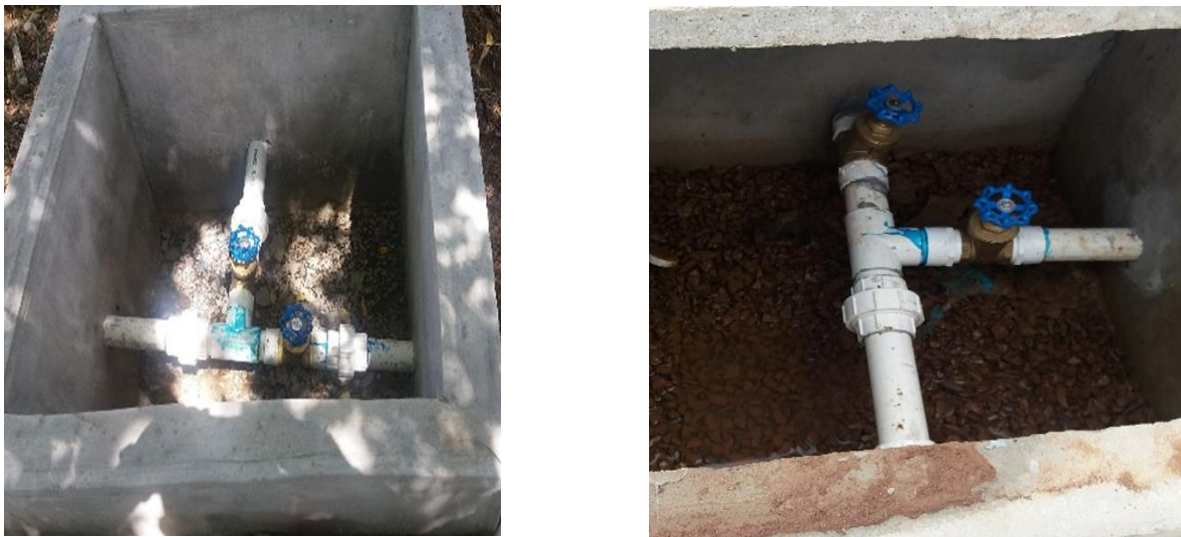
Figura 41- Vistas de cajas de válvulas de expulsión de aire - El Limón
