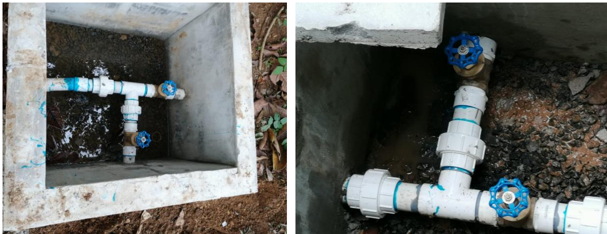
Figura 24- Vistas de cajas de válvulas de Limpieza
