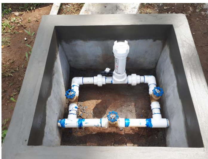
Figura 22- Caja y clorinador nuevo - Barriada San Antonio
