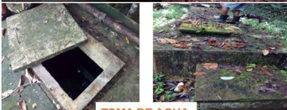
TOMA DE AGUA
