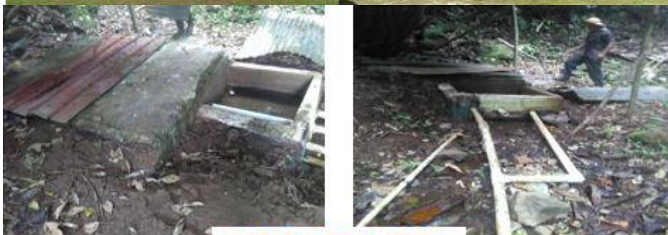
TOMA DE AGUA
