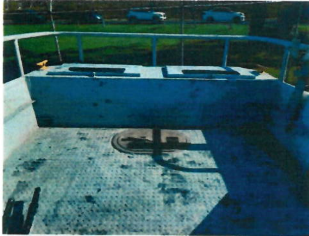
Foto 5-Compartimientos de cuarto de baterías y tanques de combustible.
