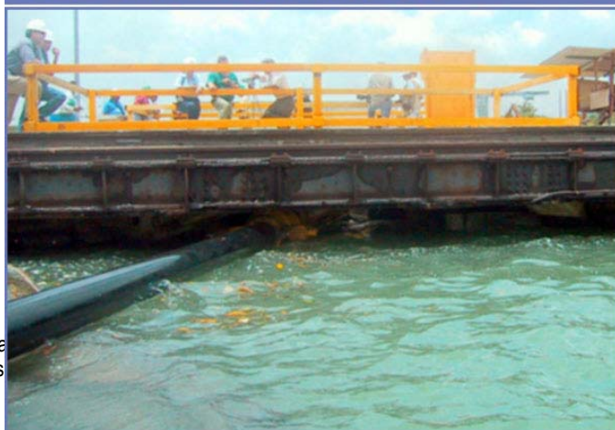
Figura 5-17 Brazo hidráulico que opera las compuertas con el sello para prevenir la entrada de agua por la elevación del nivel del lago Miraflores.
