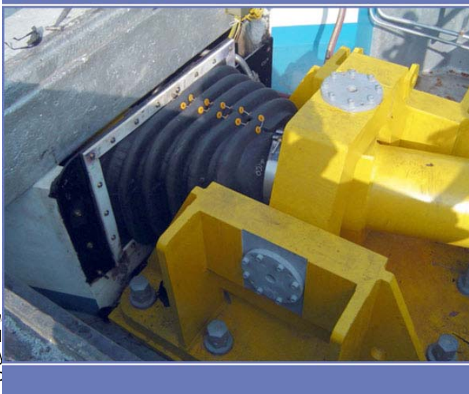
Figura 5-18 El sistema de sellado para los brazos hidráulicos de las esclusas consiste en una bota de caucho que impide el ingreso de agua a los túneles donde se ubican los cuartos de máquina y equipos de las esclusas.
