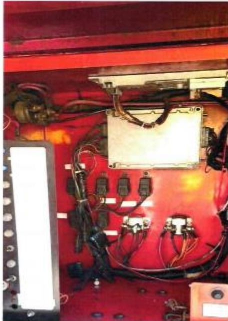
Ilustración 9 Vista de caja de fusible
