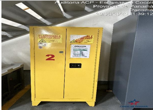
Gabinete de Almacenamiento de productos químicos peligrosos.
