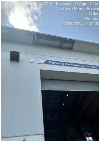
Se observó panel de techo con corrosión (Agua Clara)
