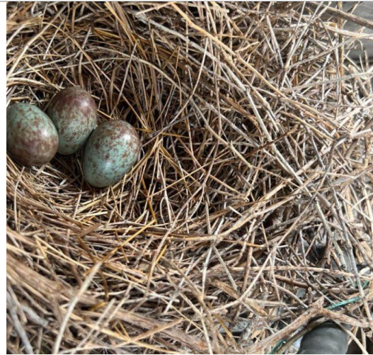
En la PTAR de Isla: Se observaron anidaciones y huevos de aves dentro de los equipos de sopladores.
