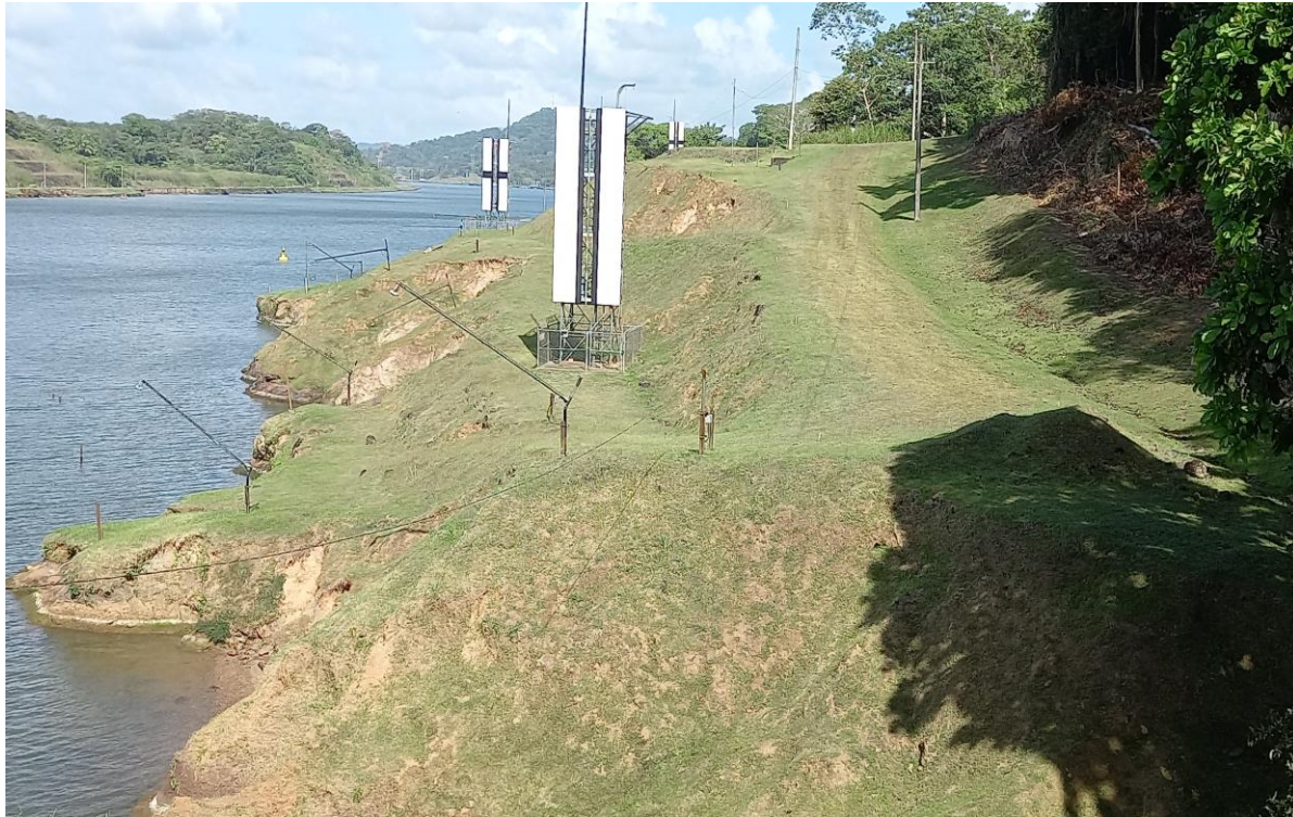
Deslizamiento en el sector Bas Obispo. Monitoreo de puntos de control. Estacionado 52+900 a 52+700, ribera este
