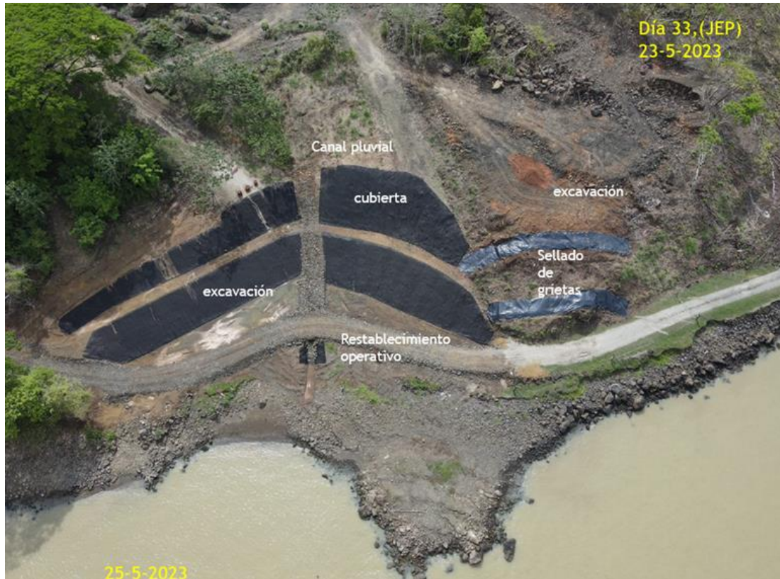
Reactivación de deslizamiento en Culebra. Trabajos de excavación y sellado de grietas.
