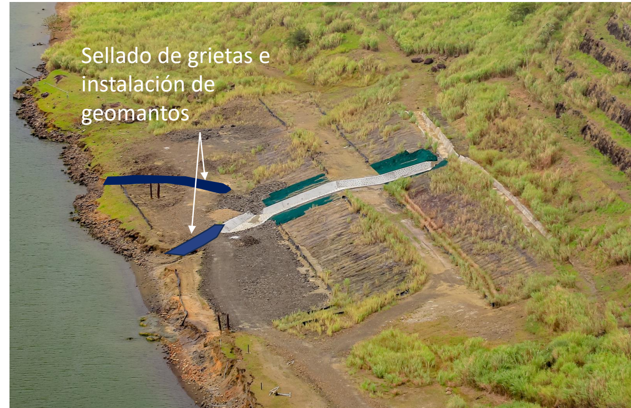
Reactivación de deslizamiento en Hodges. Trabajos de conformación y sellado de grietas. Marzo 2023.
