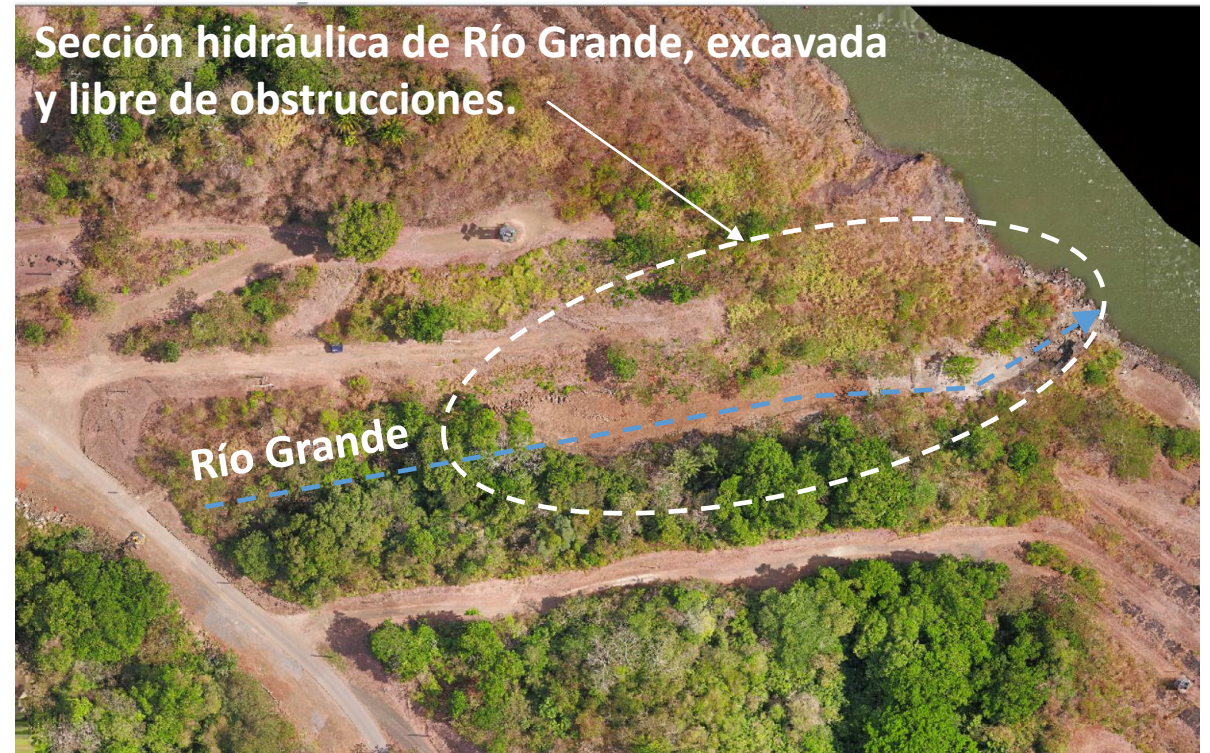
Deslizamiento en el sector Contractor. Excavación y limpieza del tramo final de Río Grande . 60+380 a 60+500, ribera oeste
