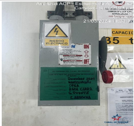
Certificación de Grúa Puente de Agua Clara vigente / Señalización de Riesgo Eléctrico
