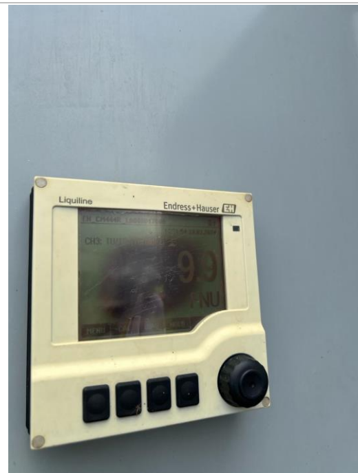
Se tomó nota de puntos por mejorar: Corrosión en tuberías (Isla), Reemplazo de monitor de Turbiedad, Se observó que se están reemplazando puertas por corrosión.
