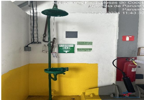
Señalización y Acondicionamiento de las Duchas / Lavados de Ojos.
