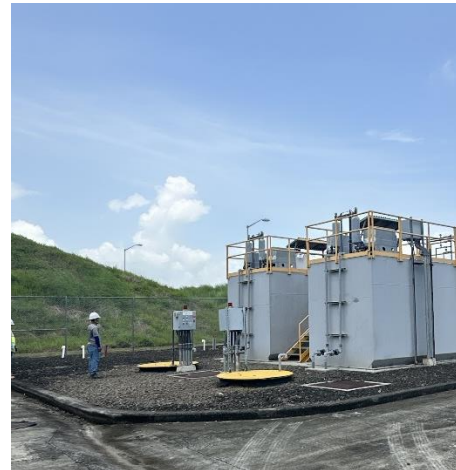
Evidencia de visitas a PTARs y Separadores Agua/Aceite
