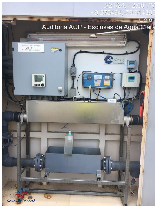
Se observaron mejoras: Desinfección luz UV, Control del caudal, No se observaron variación ni picos en los parámetros de turbiedad ni excedencias al umbral.
