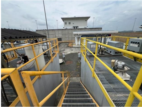
Evidencia de visitas a PTARs y Separadores Agua/Aceite
