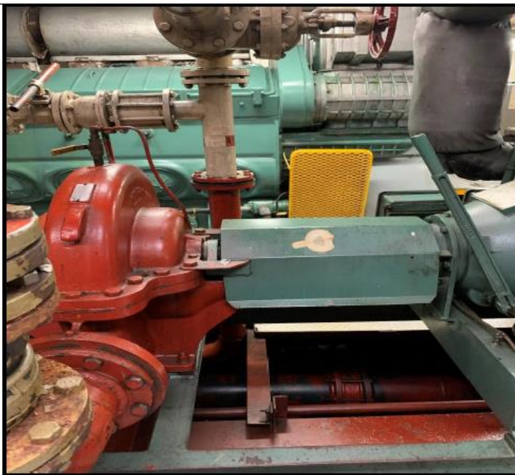
Figura N°14. Bomba FIFI (Operativo).
