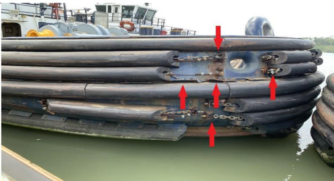
Figura N°38. Cadenas, láminas y elementos de sujeción de las defensas en proa/estribor, averiados y afectados por corrosión.
