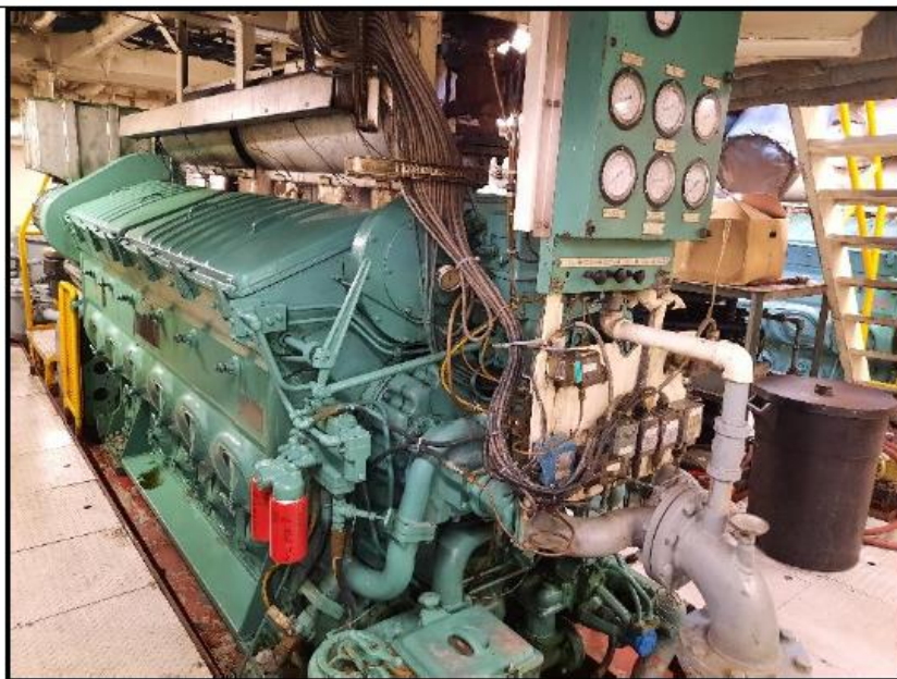
Figura N°2. Máquina principal de babor (Operativo).
