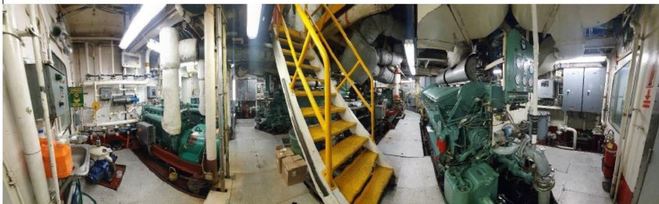
Figura N°33. Condición del cuarto de máquinas. (Buena).
