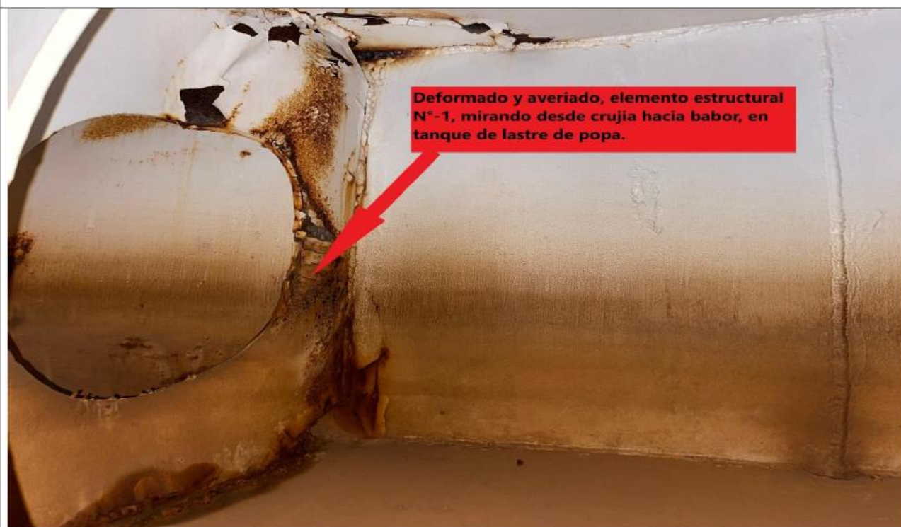
Figura N°36. Averiado y deformado elemento estructural N°-1. (Tanque de lastre de popa)
