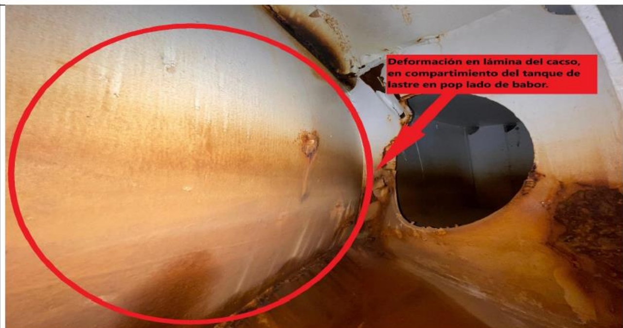
Figura N°35. Deformación en lámina de casco en la popa del lado de babor (Tanque de lastre de popa).
