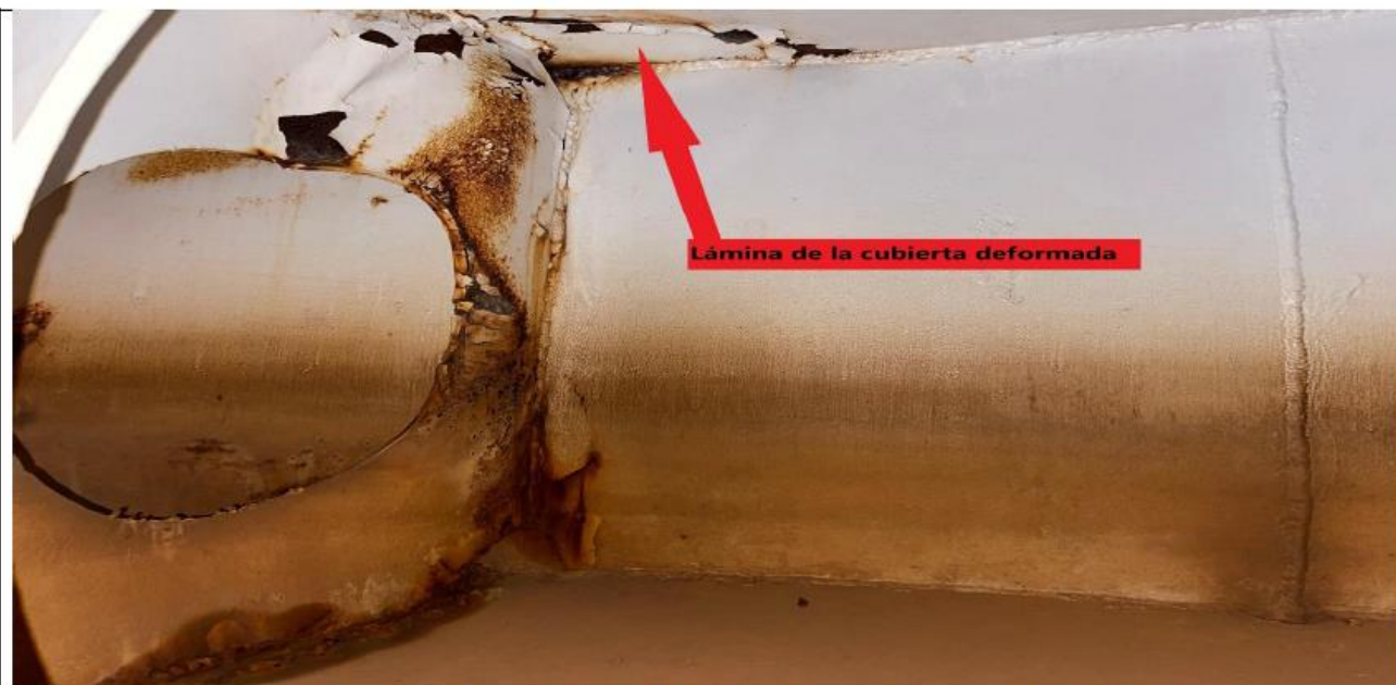
Figura N°37. Deformación en lámina de la cubierta (Tanque de lastre de popa).
