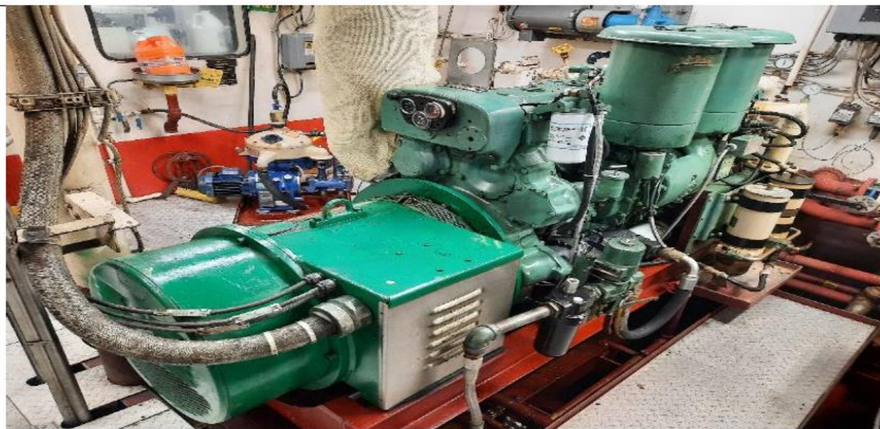
Figura N°9. Generador N°2 (Operativo).
