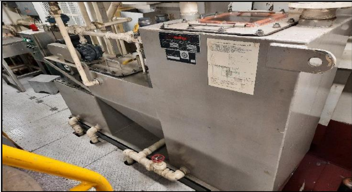
Figura N°16. Planta de tratamiento. (Operativo)
