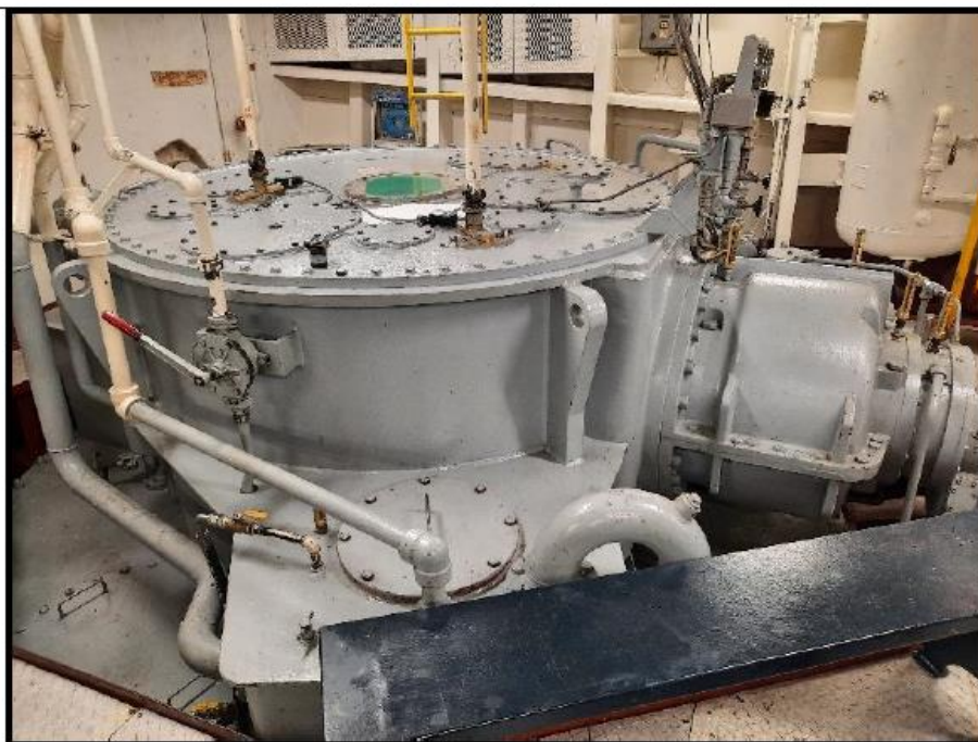
Figura N°5. Sistema de propulsión de estribor (Operativo).
