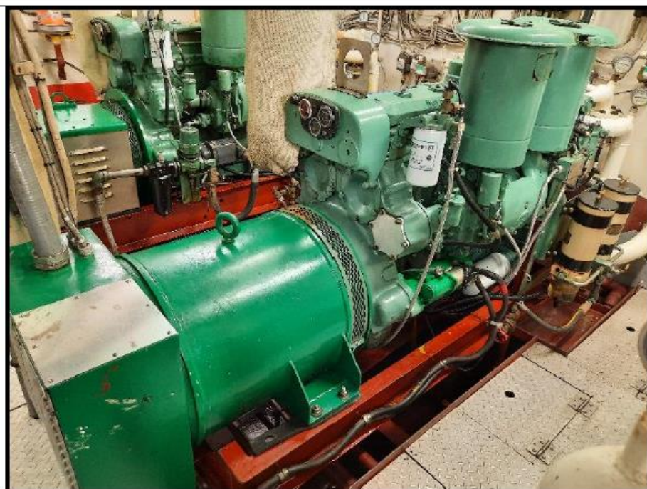
Figura N°8. Generador N°1 (Operativo).
