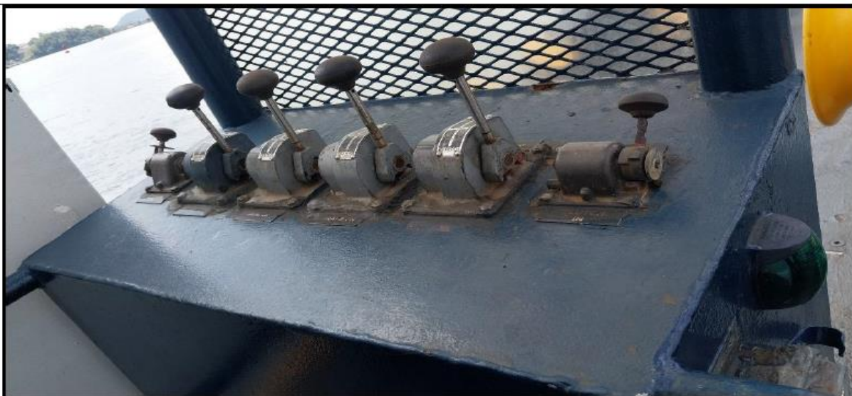
Figura N°21. Control de los winches (Operativo).
