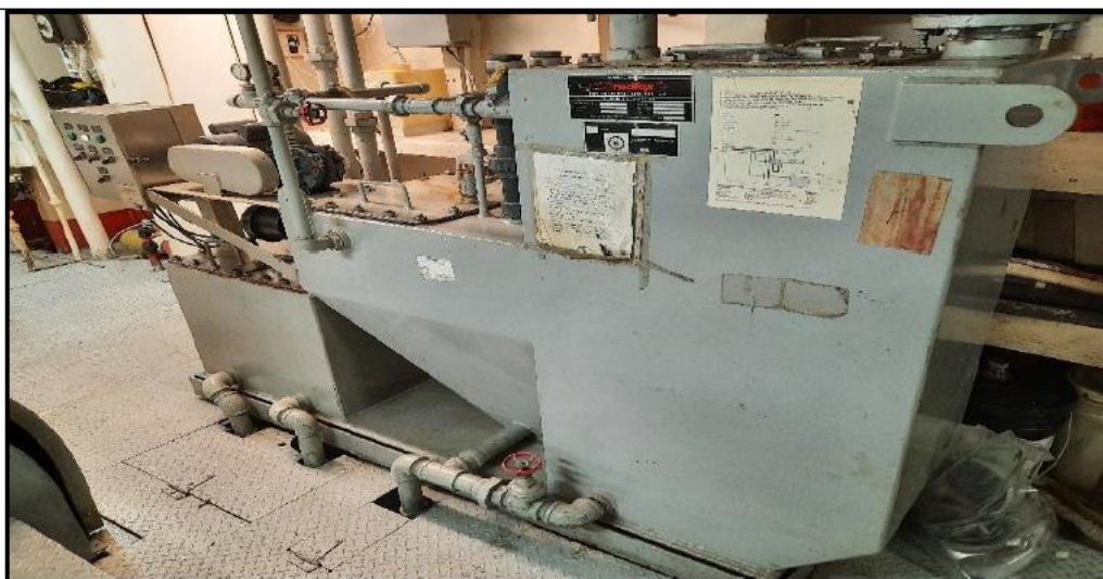
Figura N°16. Planta de tratamiento. (Operativo)
