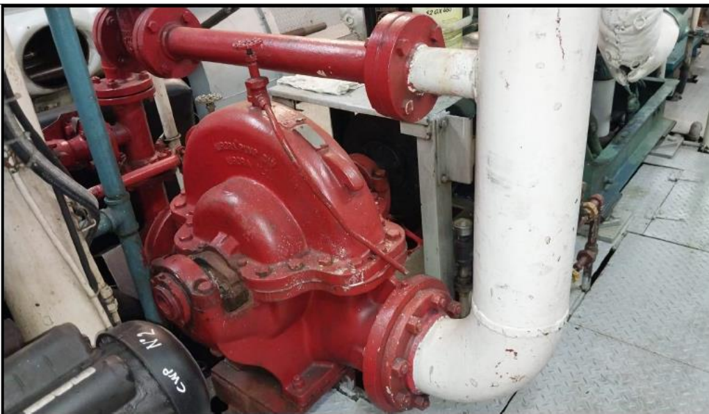
Figura N°14. Bomba FIFI (Operativo).
