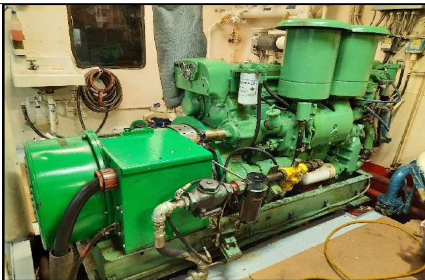
Figura N°8. Generador N°1 (Operativo).
