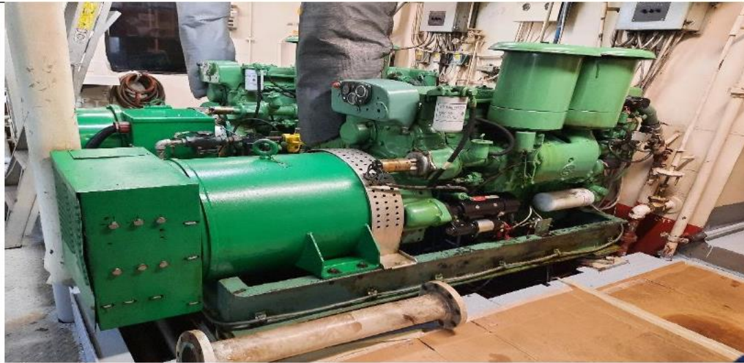
Figura N°9. Generador N°2 (Operativo).
