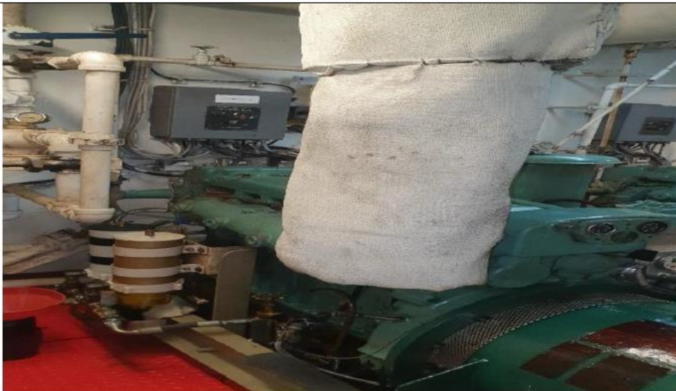
Figura N°9. Generador N°2 (Operativo).
