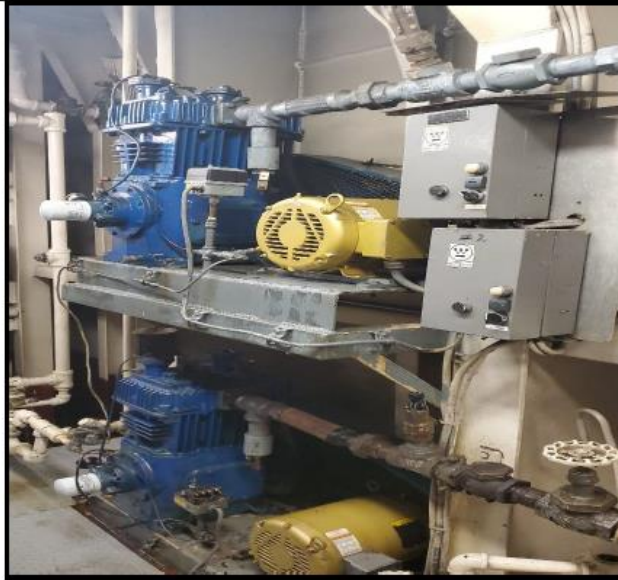
Figura N°11. Compresor N°1 y N°2 (Operativo).
