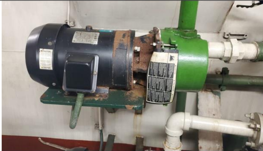
Figura N°23. Bomba de “Ballast tank” (No Operativa).
