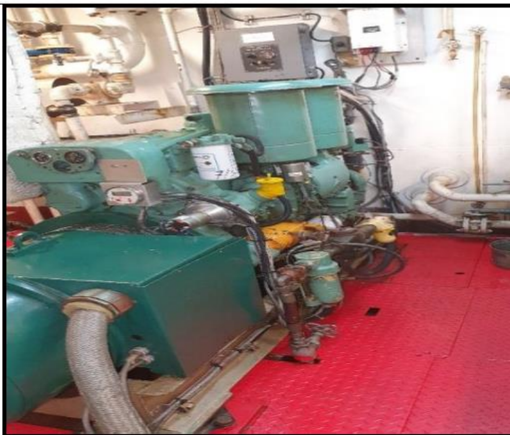
Figura N°8. Generador N°1 (Operativo).
