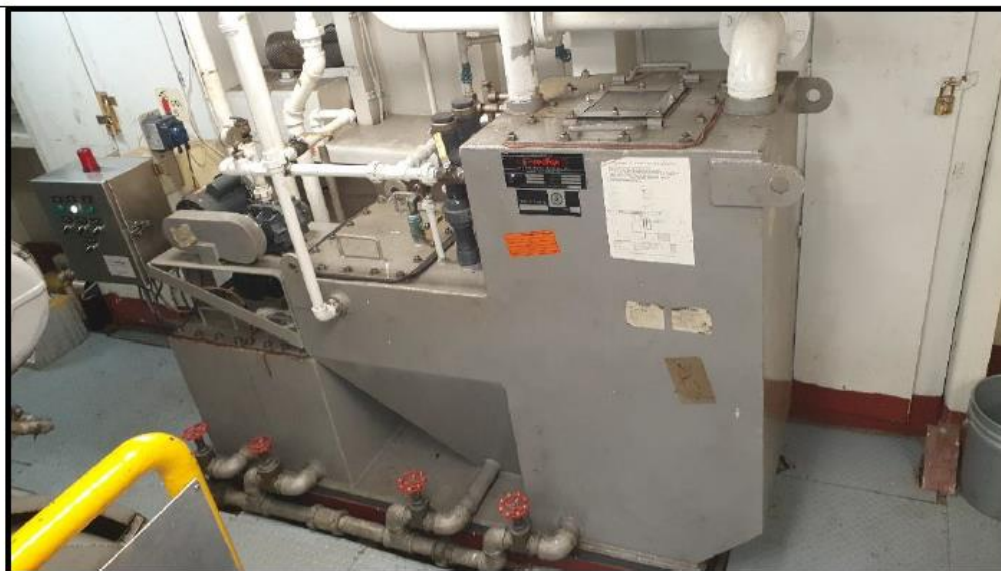
Figura N°16. Planta de tratamiento. (Operativo)
