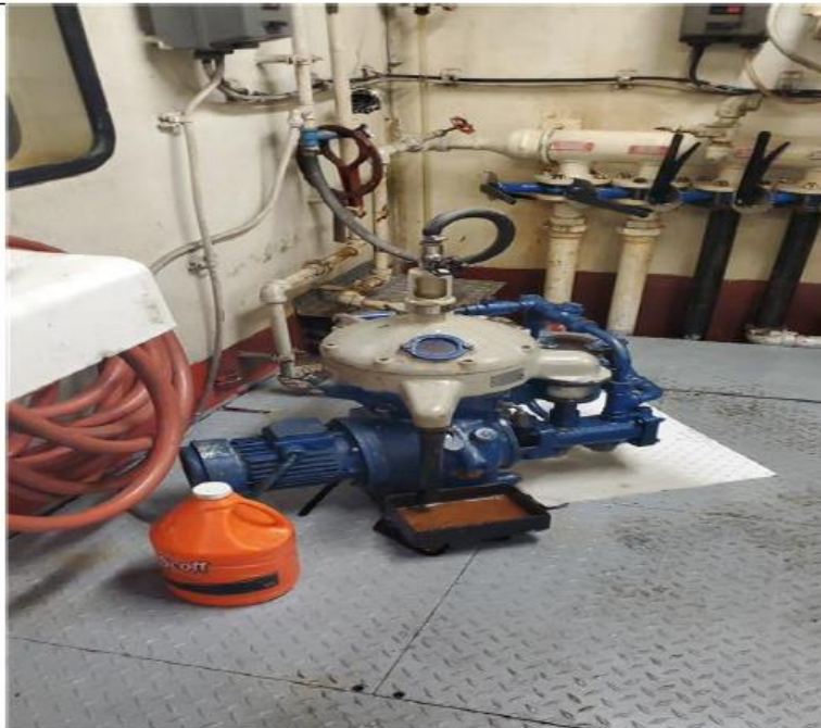
Figura N°22. Bomba de combustible (ok).
