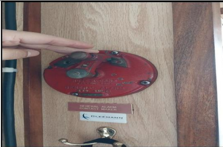
Figura N°27. Alarma general en el puente (Operativo).
