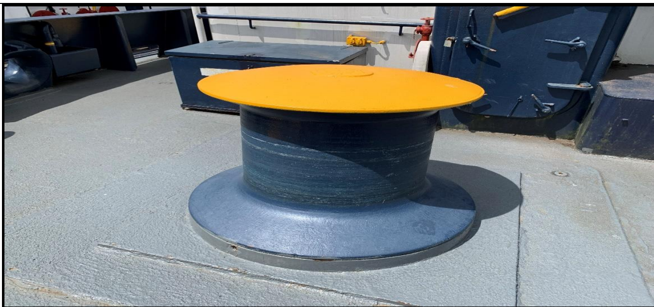
Figura N°22. Winche en popa (Operativo).
