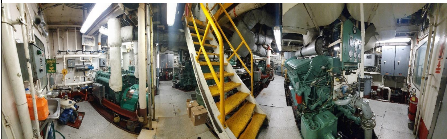
Figura N°33. Condición del cuarto de máquinas. (Buena).
