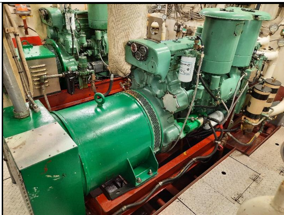
Figura N°8. Generador N°1 (Operativo).
