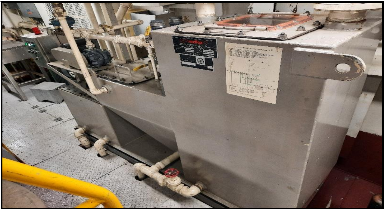
Figura N°16. Planta de tratamiento. (Operativo)
