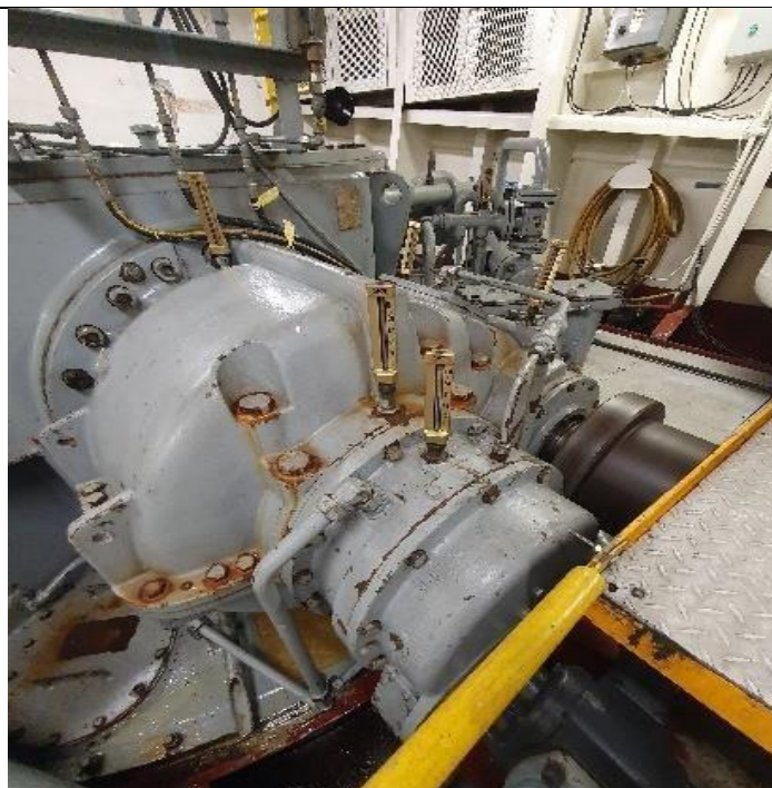
Figura N°7. Convertidor de torque de estribor (Operativo).
