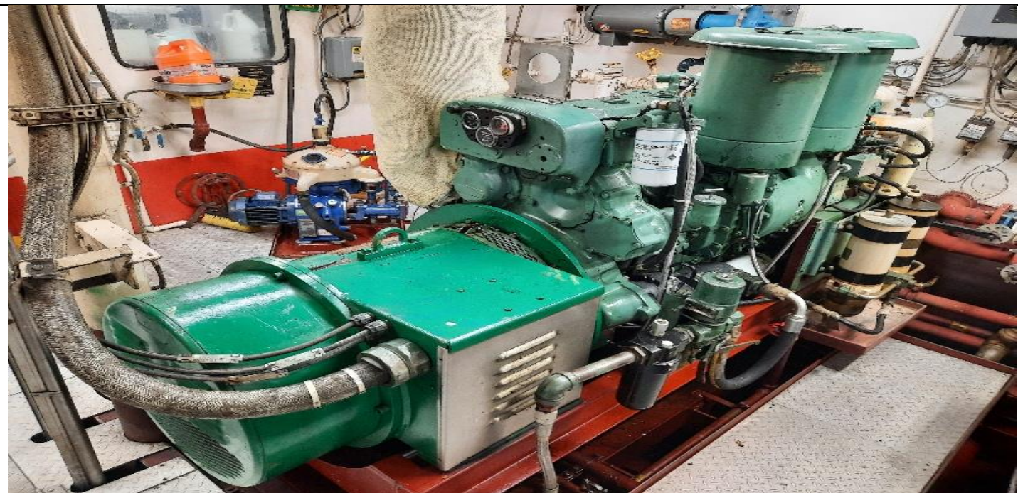
Figura N°9. Generador N°2 (Operativo).
