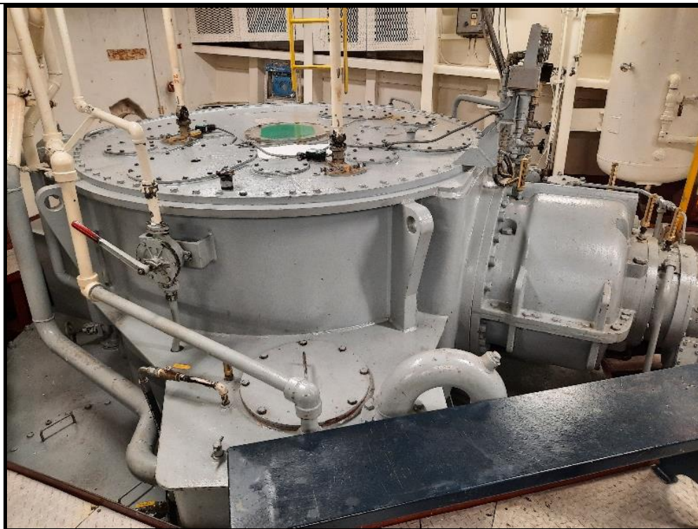
Figura N°5. Sistema de propulsión de estribor (Operativo).
