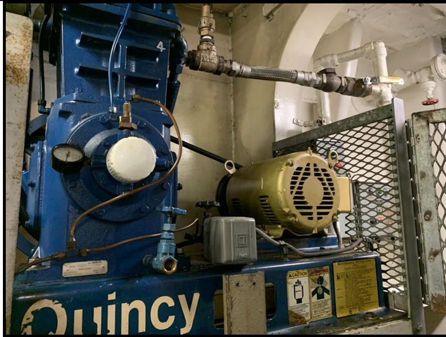
Figura N°11. Compresor N°1 (Operativo).
