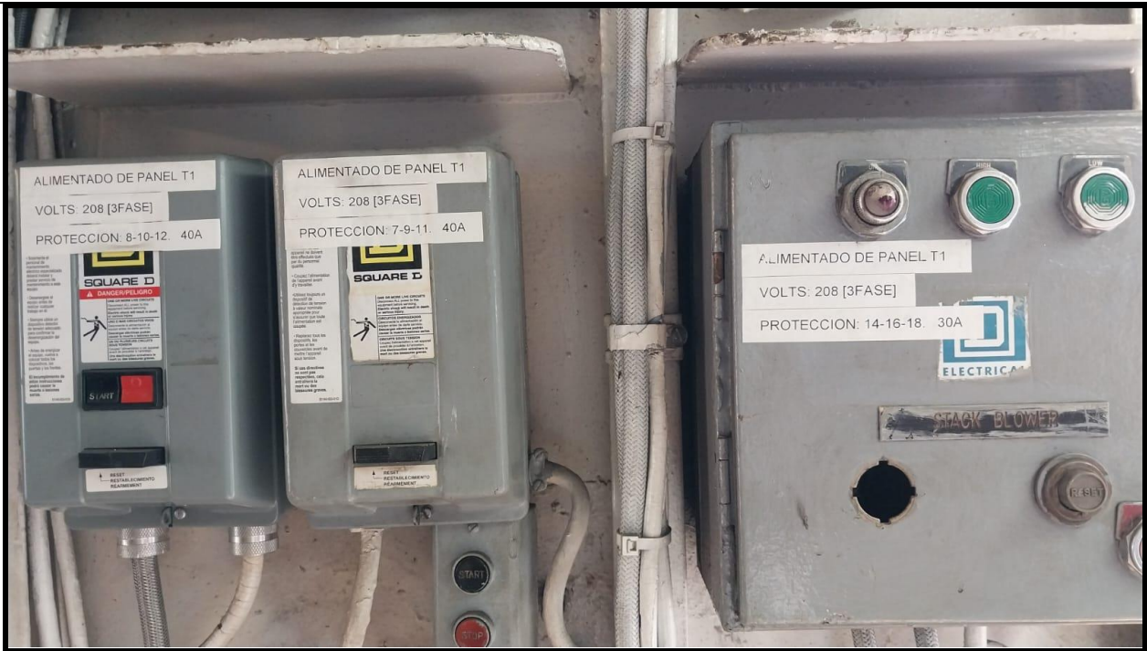
Figura N°15. Ventiladores, extractor y sus paneles de control (Operativo).
