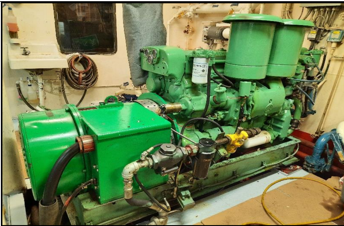
Figura N°8. Generador N°1 (Operativo).
