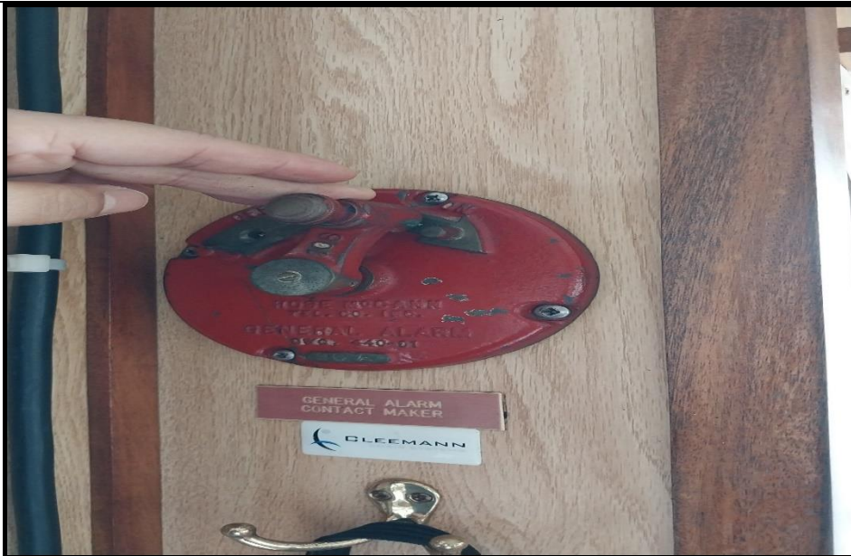
Figura N°26. Alarma general en el puente (Operativo).
