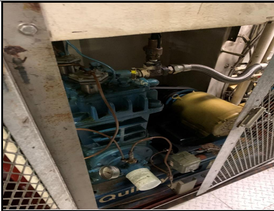
Figura N°12. Compresor N°2 (Operativo).
