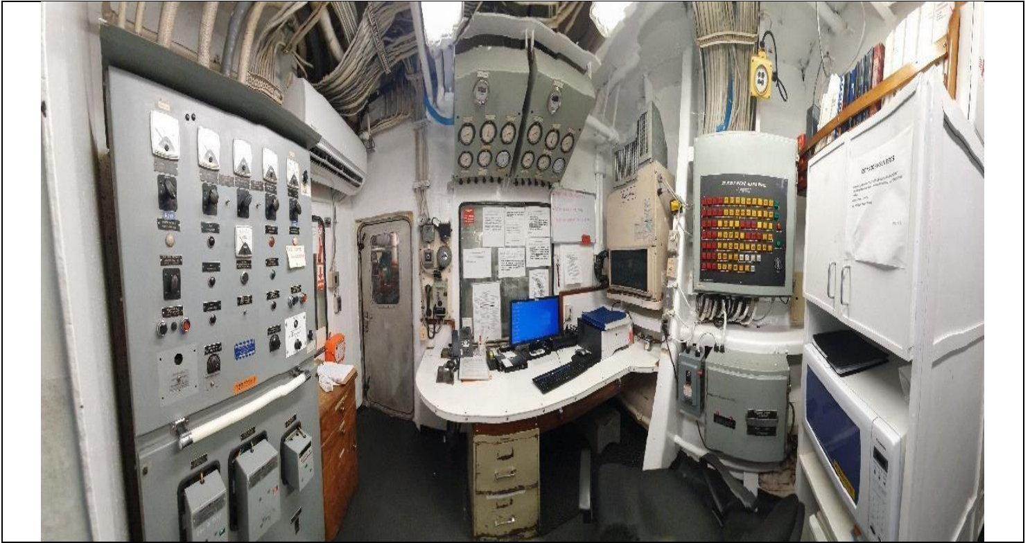
Figura N°32. Condición de cabina de control del jefe de máquinas. (Buena)
