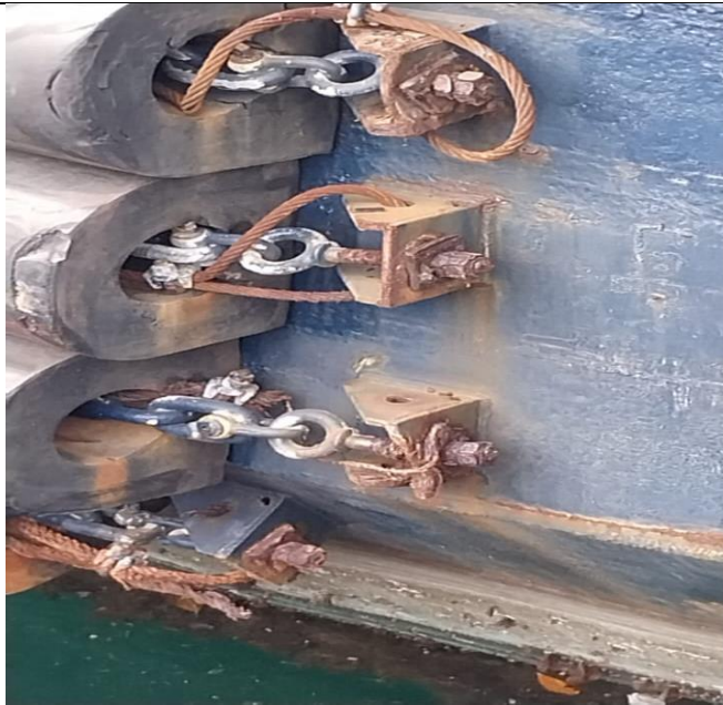
Figura N°33. Cadenas, láminas y elementos de sujeción de los defensas afectados por corrosión, en proa y popa de los lados de babor y estribor presentan esta condición.
